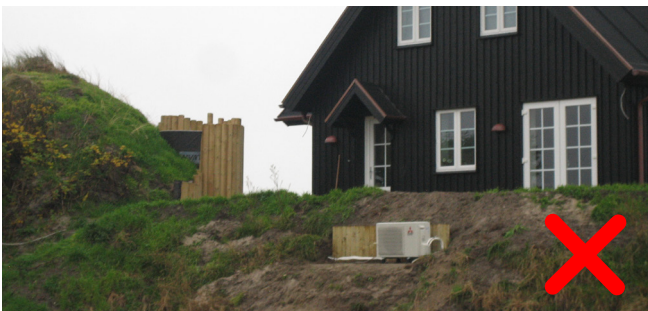
Varmepumpe ikke indbygget eller indpakket.
